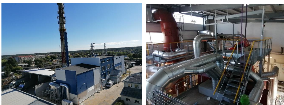
Fot. 22. Kocioł na biomasę
